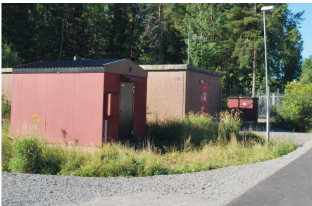
Elanläggning intill gång- och cykelbana i norr.
